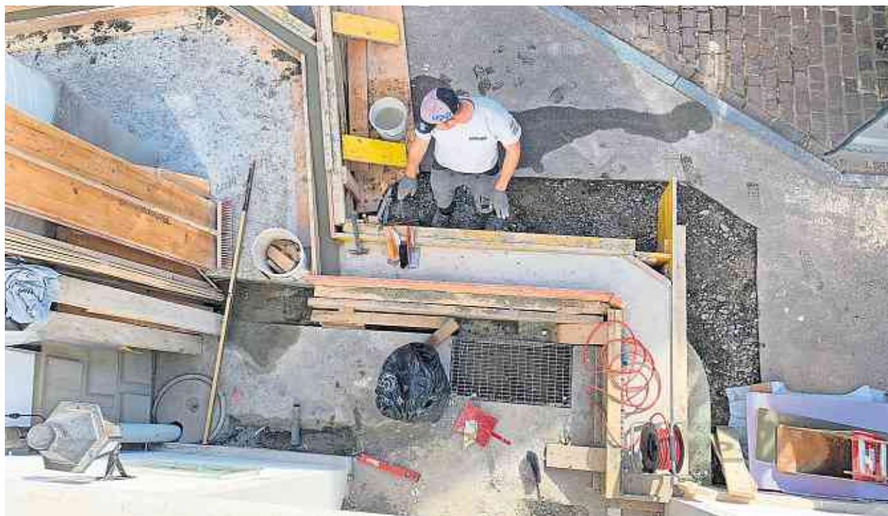
IDSK Von oben herab: der barrierefreie Zugang zum Stadthaus nimmt Form an.
