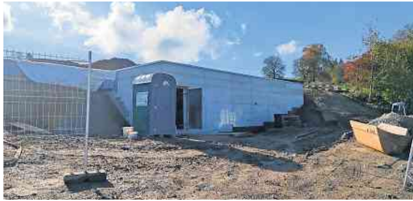
So präsentiert sich derzeit die Baustelle Reservoir Gruebhalde. Auf www.taegerwilen.ch findet sich eine kleine Chronologie in Bildern (Suchbegriff Reservoir).
